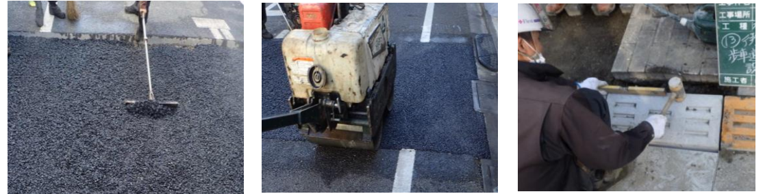
本復旧工 アスファルト舗装、街きょブロック等を新しく舗設する
