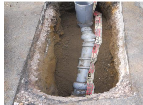
開削工事にて道路を掘削して古い管を撤去し、 新しい塩化ビニル管へ入れ替え
