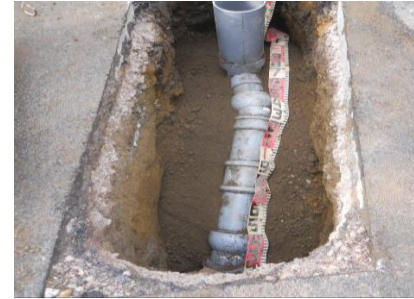
開削工事にて道路を掘削して古い管を撤去し、 新しい塩化ビニル管へ入れ替え
