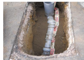
道路を掘削して古い管を撤去し、 新しい塩化ビニル管へ入れ替え
