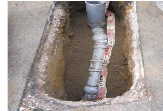
掘削して 新しい塩化ビニル管へ 入替えた「本管と取付管」
