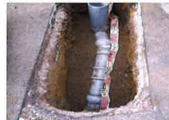
掘削して新しい強化ビニル管へ入替えた「本管と取付管」
